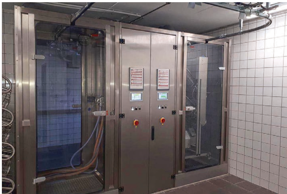
Die zwei Waschmaschinen der Firma MAW.
