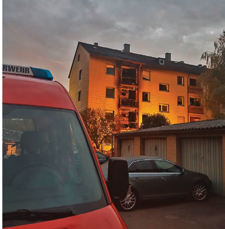
Nach dem Einsatz: drastische Schäden am ganzen Haus.
